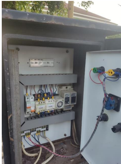
Gambar 3 Pengecekan Panel Kontrol Pompa
